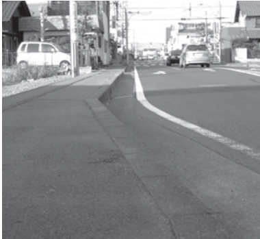
▲段差のある歩道
