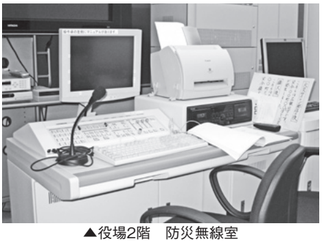
▲役場2階 防災無線室
