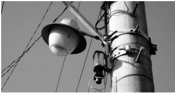
▲町内に設置されている防犯灯
