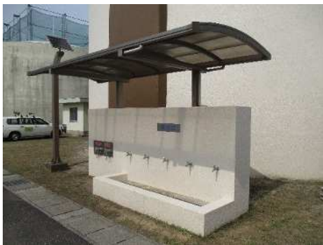
■写真 3-7 水源地内緊急給水設備
