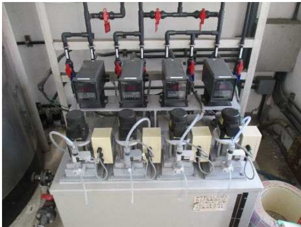
■写真 3-3 塩素注入設備
