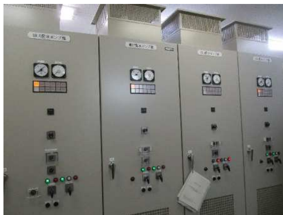
■写真 7-3 配水ポンプ盤 (参考写真)
