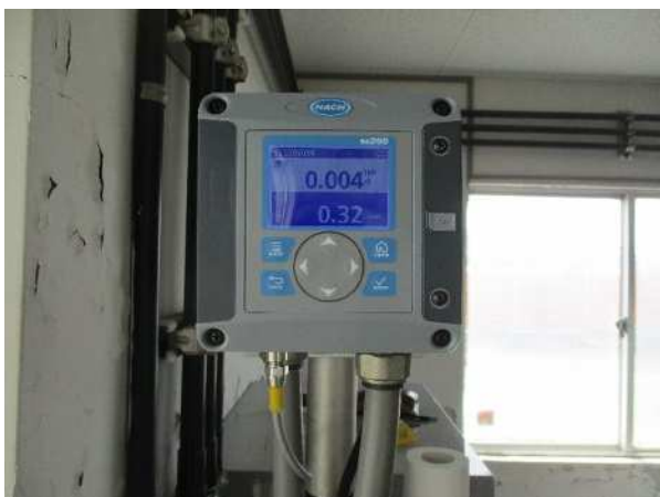
■写真 3-5 原水濁度計
