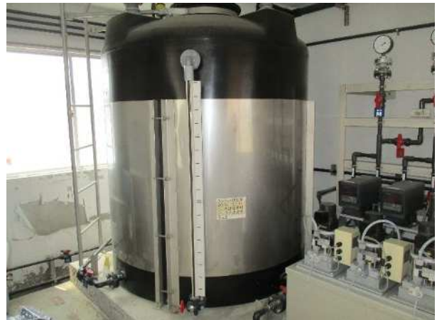
■写真 3-4 塩素タンク
