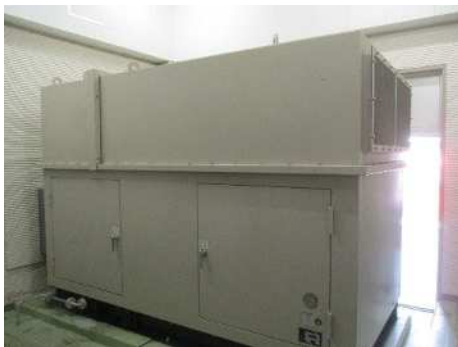
■写真 3-9 自家発電機
