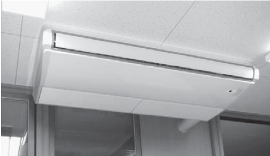
教室に設置されたエアコン
